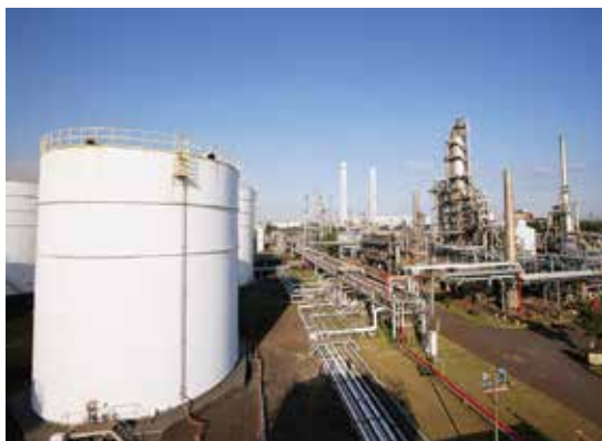
原料タンクとフタル酸・BTX 製造設備
