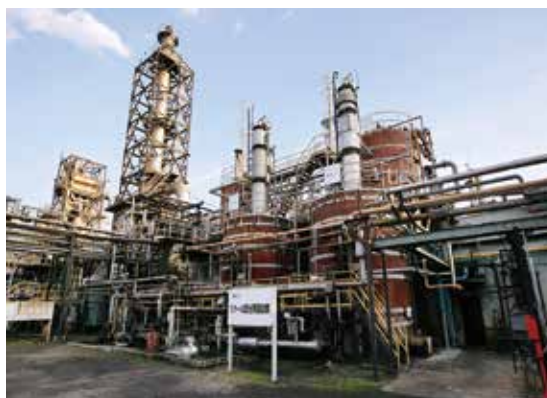
連続・回分タール蒸留設備
