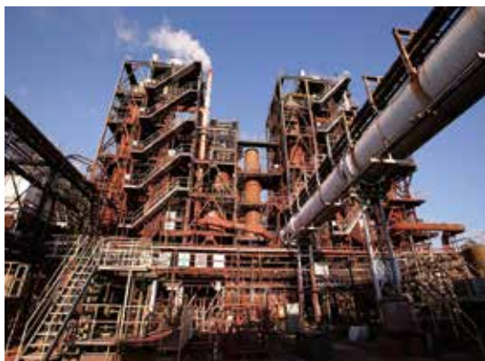
酸化鉄製造設備
